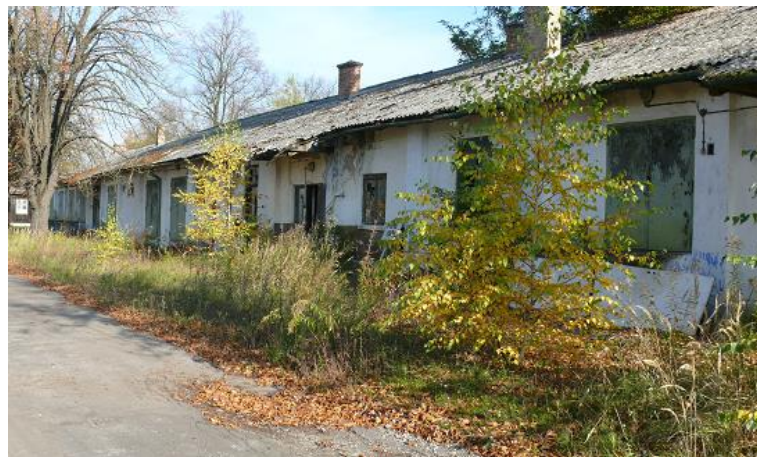
Prvorepublikové barákové kasárny Malacky, Slovensko, středová ulice mezi baráky č. XXXVII a XXXVI- Roku 1946 obývali tyto baráky slovenští a maďarští váleční zajatci. Zděný barák č. č. XXXVIII sloužil coby hospodářské zázemí zajateckého tábora (LCH2013)
