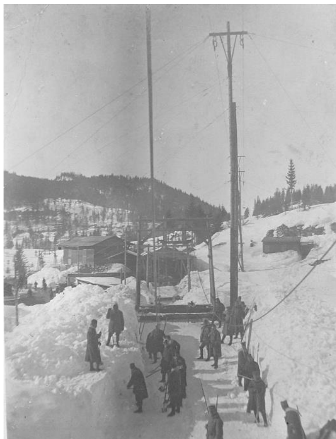
Srbští váleční zajatci přidělení na obsazené území Itálie, na stavbu transportní lanovky
