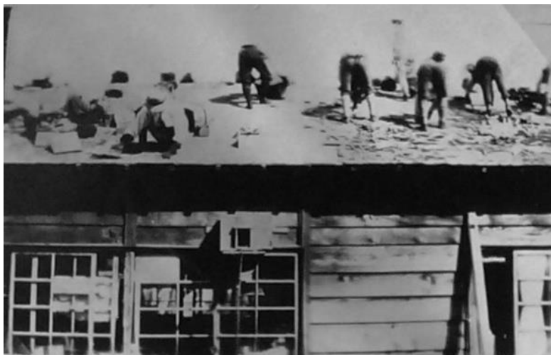
Zajatci nasazení na pokládce střešní krytiny na jednom z obytných baráků tábora Krume
